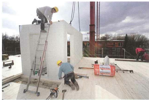
Zwei Arbeiter aus der Holzbaufirma genügen auf der Baustelle für die Umsetzung aller Arbeiten.
